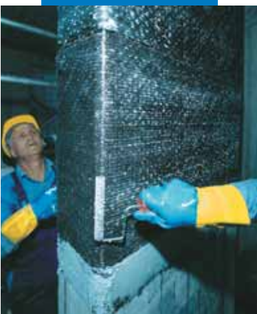
Presión efectuada sobre el tejido con el Rodillo para MapeWrap, para hacer penetrar MapeWrap 31 en el tejido
