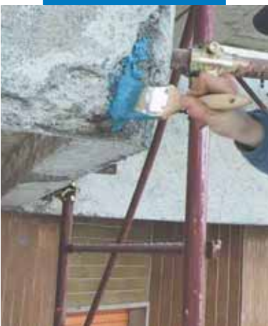
Aplicación a brocha de Mapefer 1K sobre los hierros de la armadura en un balcón de hormigón armado
